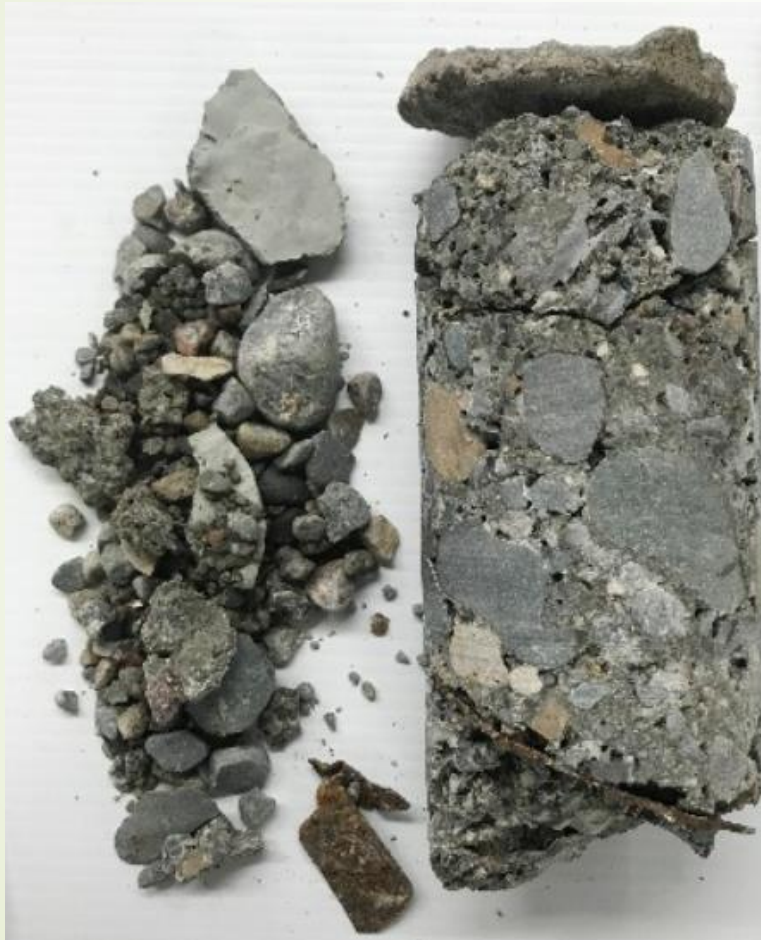
Présence de granulats de toutes sortes et d'un morceau métallique dans la CR-6
